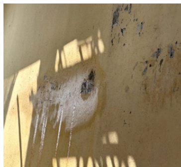
Tường bị thấm từ nhà vệ sinh
