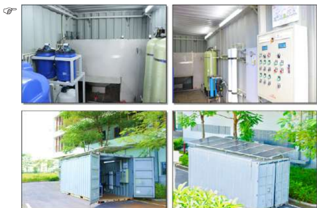
Hệ thống tích hợp xử lý nước mặn, nước phèn tại VKIST (Ảnh tư liệu).
