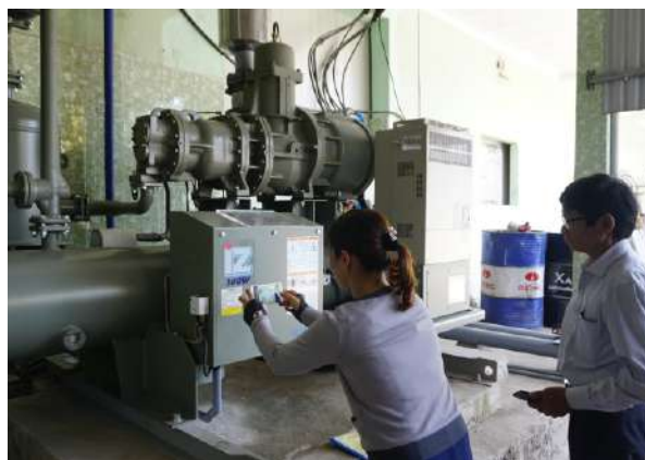
Nhà máy Chế biến thủy sản Hưng Phong được đầu tư đổi mới thiết bị, công nghệ trong cấp đông sản phẩm.
