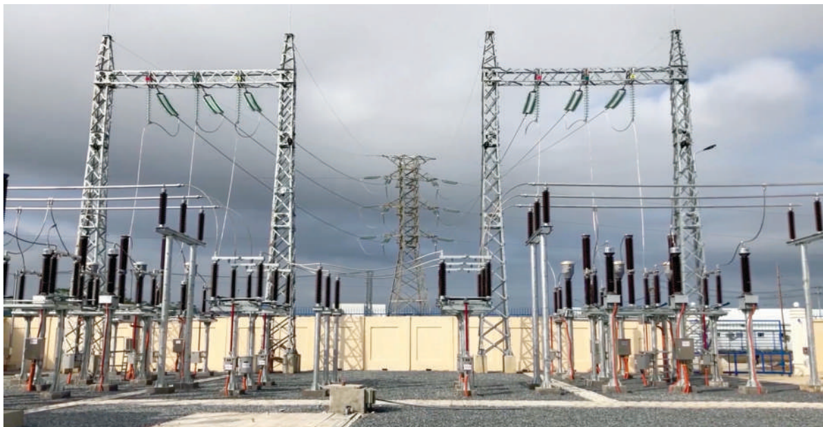
Trạm biến áp 110kV VSIP Quảng Ngãi.
