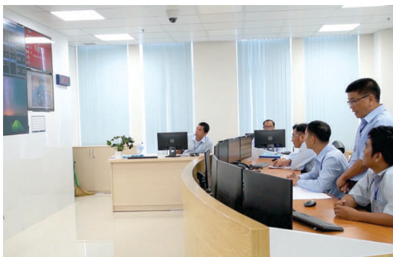
Trung tâm điều khiển SCADA Công ty Điện lực Quảng Ngãi.
