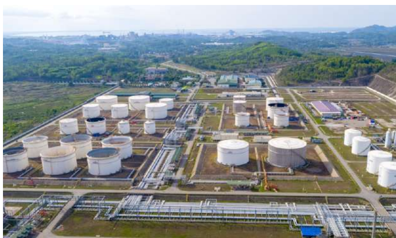
Khu bể chứa trung gian Nhà máy Lọc dầu Dung Quất.
