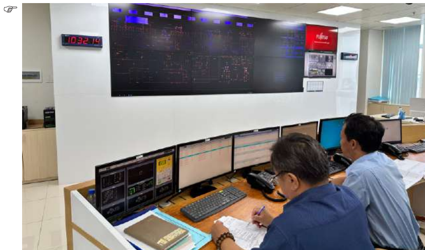
Phòng điều hành Công ty Điện lực Quảng Ngãi.
