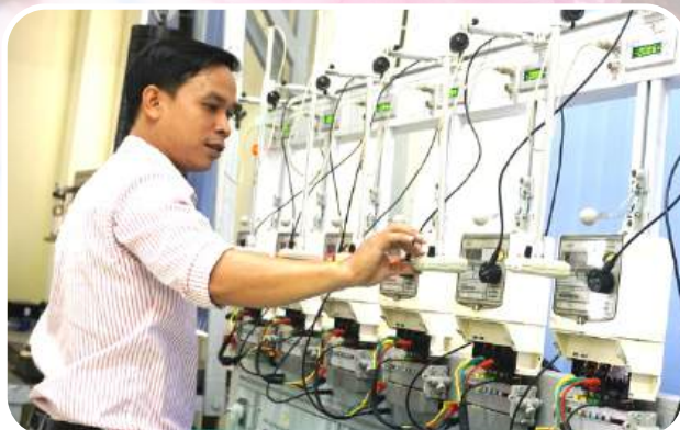
Kiểm định công tơ điện.
