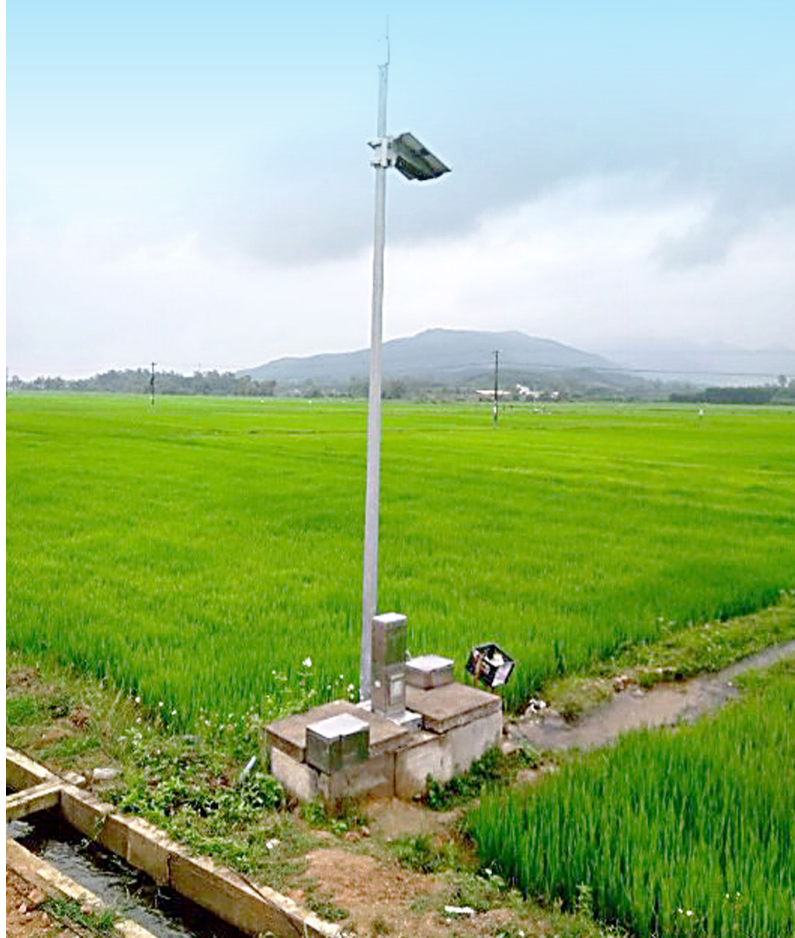
Hệ thống cửa van và thiết bị điều khiển được lắp đặt tại các kênh tưới tại xứ Đồng Sạ, xã Nghĩa Lâm.
