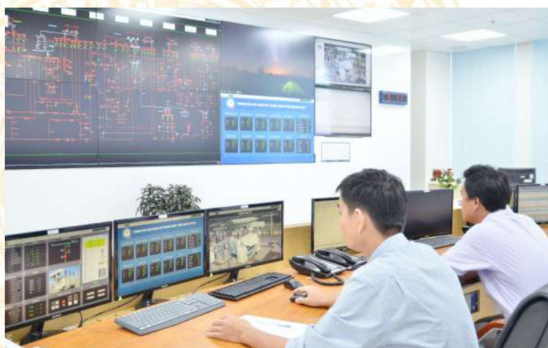
Trung tâm điều khiển SCADA-DMS Quảng Ngãi.
