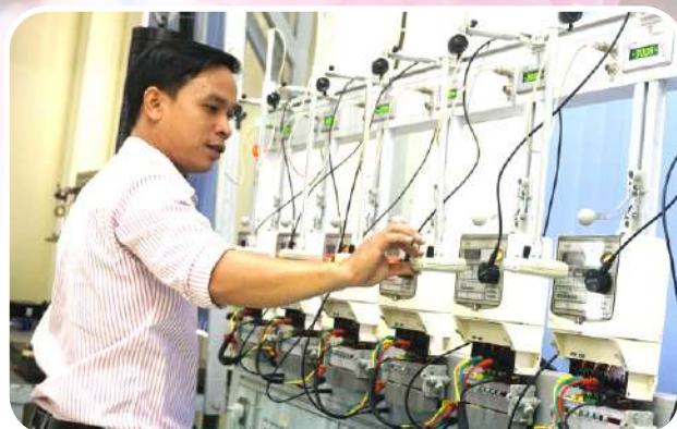
Kiểm định công tơ điện.
