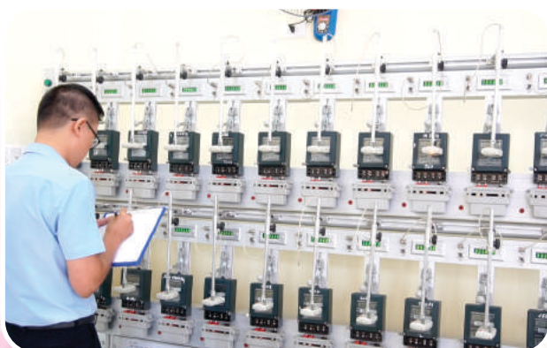
Kiểm định công tơ điện.
