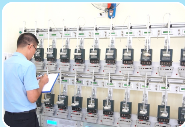
Kiểm định công tơ điện.
