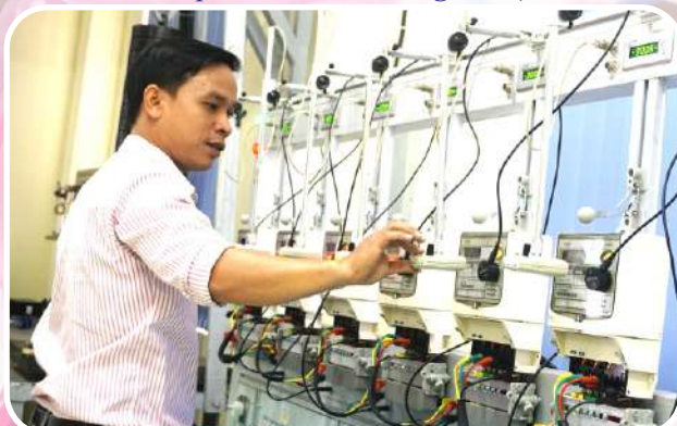
Kiểm định công tơ điện.
