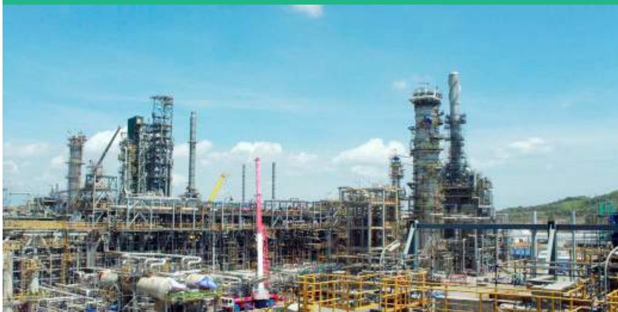
Phân xưởng chưng cất dầu thô - CDU của NMLD Dung Quất đang hoạt động ở 105% công suất.
